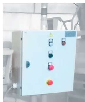
Стационарный пульт управления системами агрегата
